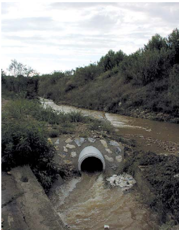
Les eaux du Rianse se déversent dans la carrière de Caveirac.
